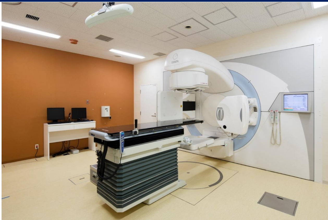
本館地下3階放射線治療室
