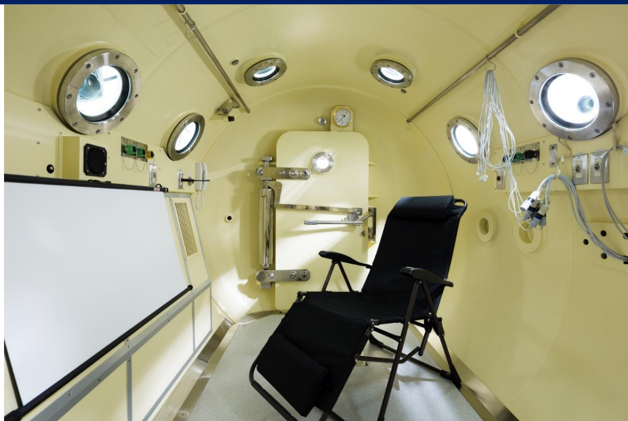
本館地下2階高気圧酸素治療室
