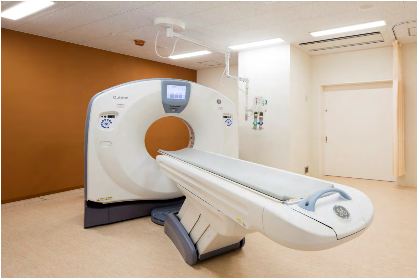
本館地下1階CT室
