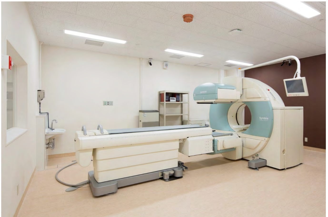
本館地下1階RI検査室
