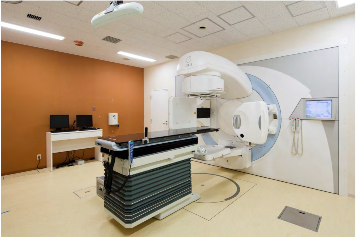
本館地下3階放射線治療室
