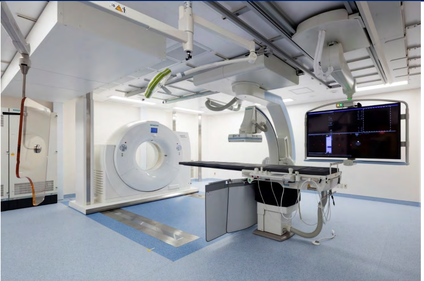
本館地下1階 アンギオ室
