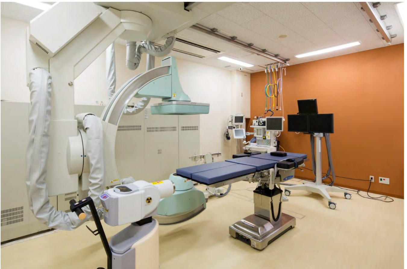
本館地下3階小線源治療室
