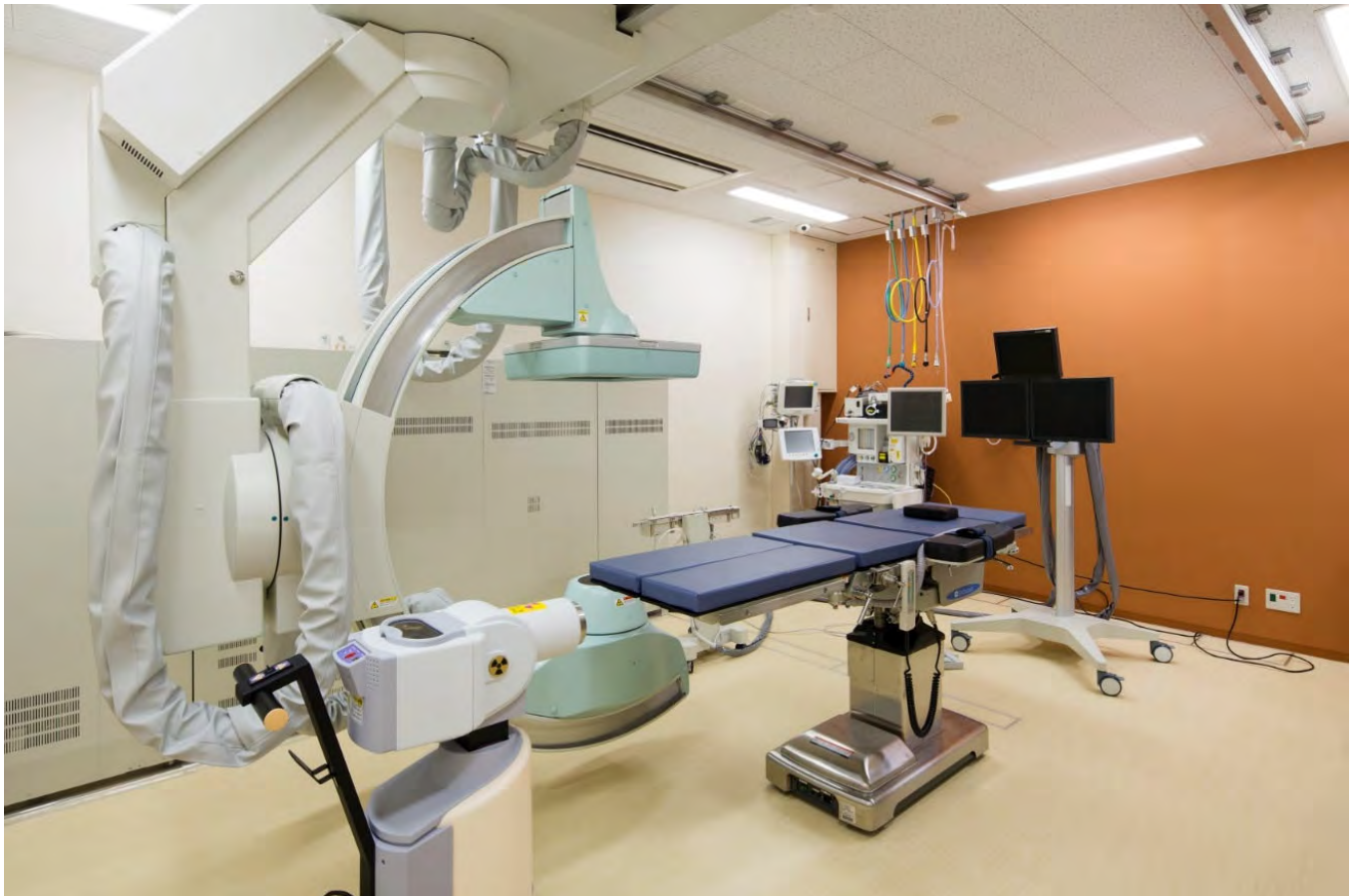
本館地下3階小線源治療室
