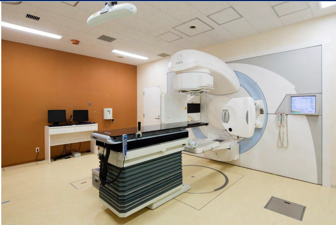
本館地下3階放射線治療室
