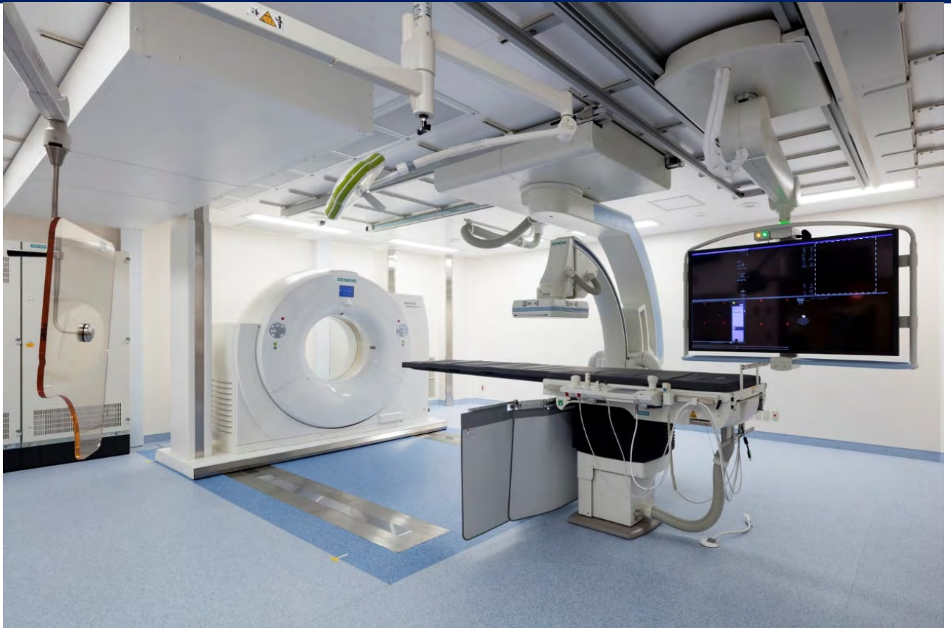
本館地下1階 アンギオ室
