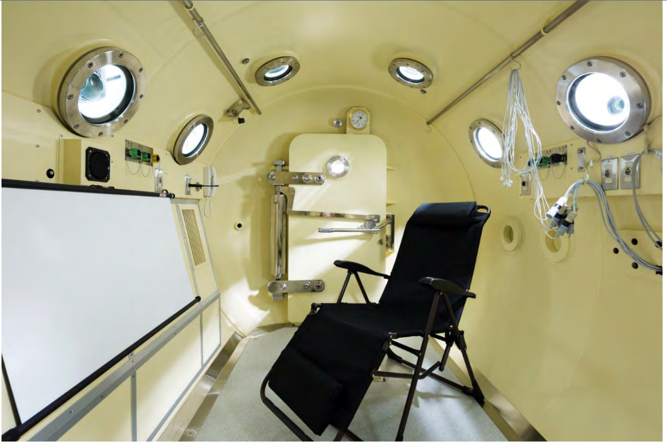
本館地下2階高気圧酸素治療室
