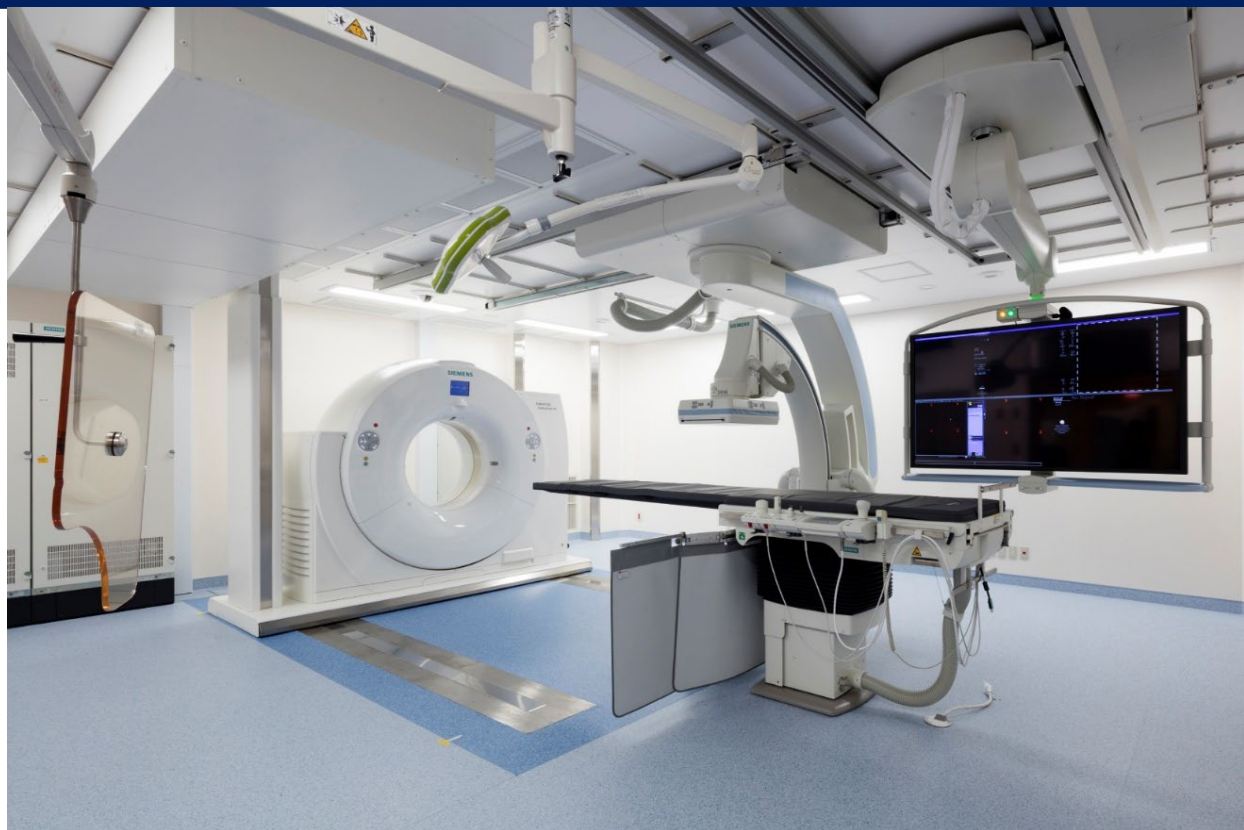
本館地下1階 アンギオ室
