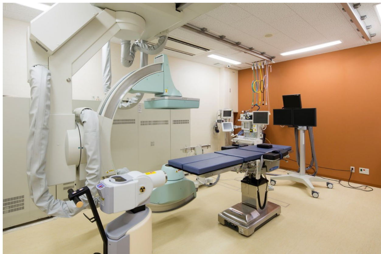
本館地下3階小線源治療室
