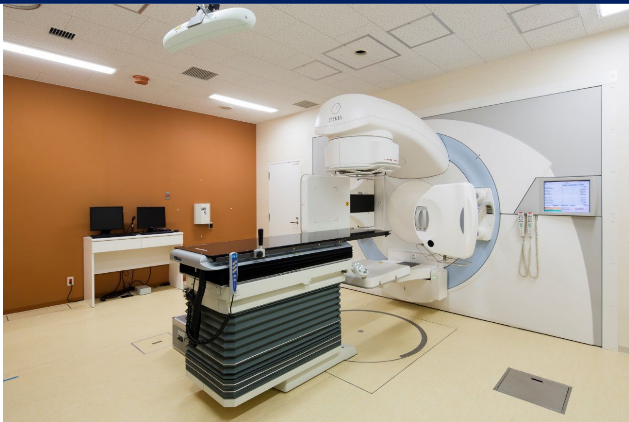
本館地下3階放射線治療室
