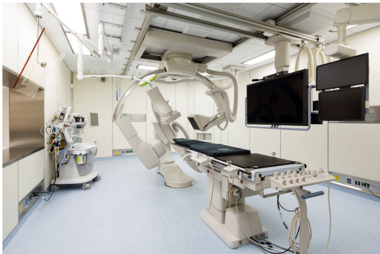
本館3階高度救命救急センター カテーテル室
