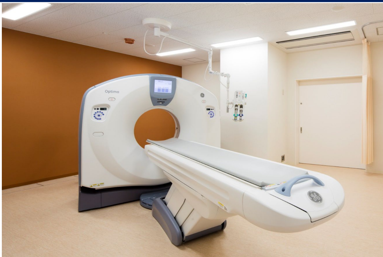
本館地下1階CT室
