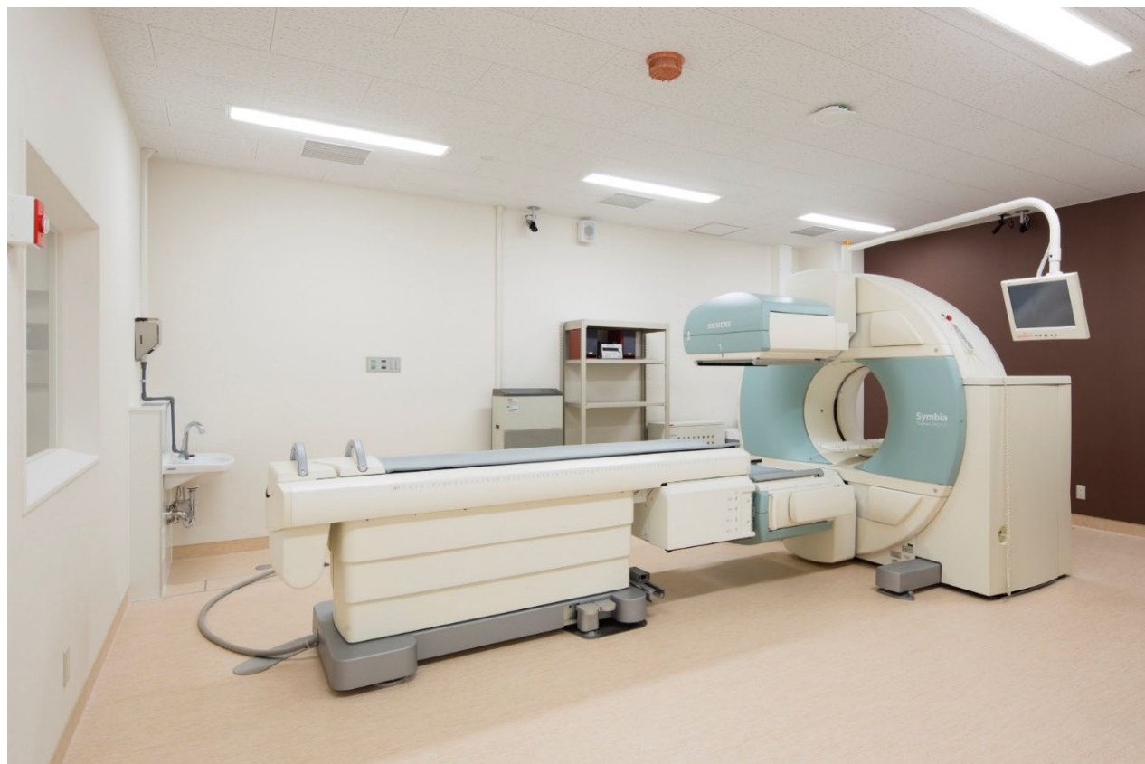
本館地下1階RI検査室
